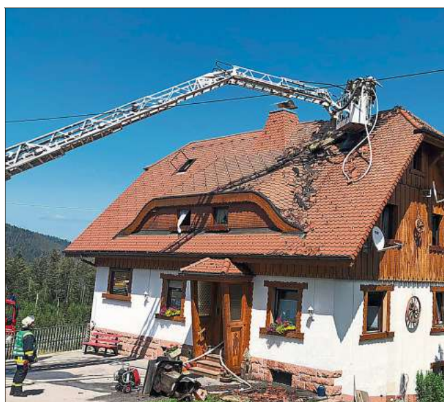
Mit der Drehleiter war die Feuerwehr Baiersbronn bei dem Dachstuhlbrand im Einsatz.
